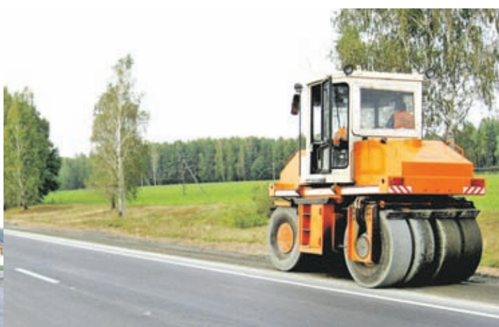
Машинист установки БЕЛТА для струйно-инъекционного ремонта асфальто-бетонного покрытия Игорь ЖИГАРЕВ выполняет работы по ямочному ремонту.
