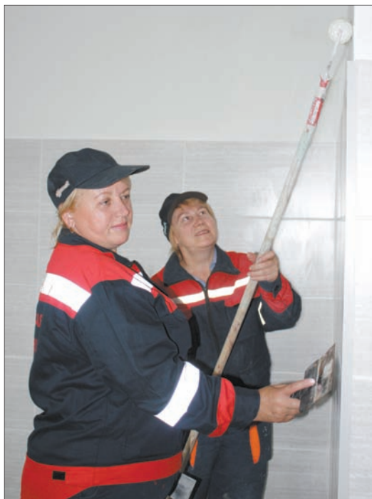
Не один десяток лет трудятся в столичной дистанции гражданских сооружений Галина АХРЕМЧИК и Людмила ЗУБАРЕВА. И не сосчитать, сколько в Минском узле с их помощью обновлено объектов. Сейчас женщины – на станции Шабаны, где идет капитальный ремонт административного здания.
