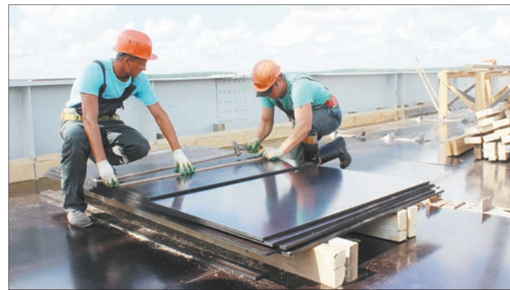
Монтаж опалубки для устройства монолитной плиты пролетного строения, выполняют работники мостоотряда № 425 ОАО «Мостострой».
